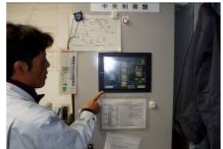
【写真：坂下総合事務所の遠方監視装置】
