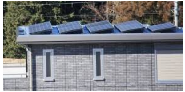
【写真:住宅の屋根に取り付けられたソーラーパネル】
