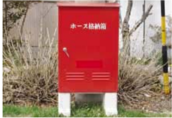
消火栓ボックス
